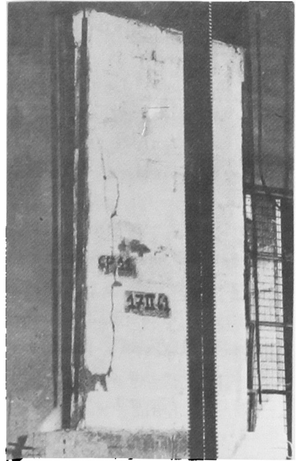
Fig. 12. Muro B 3s de 20 compresión.
