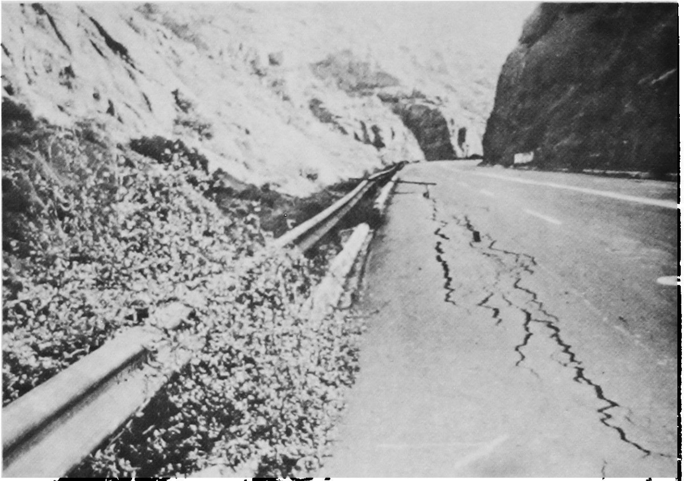
Fig. 3. Asentamiento de terraplén, cuesta Las Chilcas.
