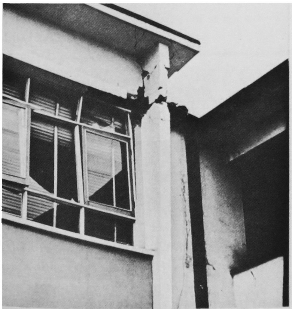
Fig. 10. Escuela de La Ligua, vista parcial de daños.
