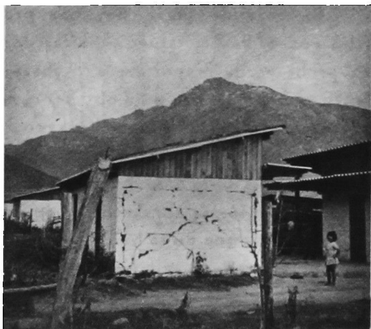
Fig. 2. Grietas típicas ocasionadas por sismos en muros de albañilería. Terremoto de julio de 1971, Valle del Choapa
