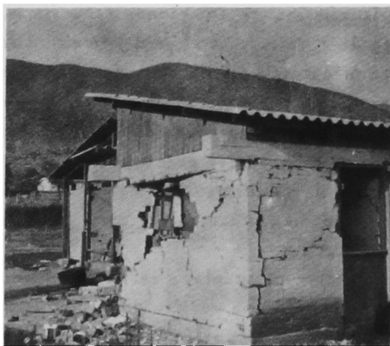
Fig. 1. Daños producidos por un sismo en muros de ladrillos. Terremoto de julio de 1971, Valle del Choapa.
