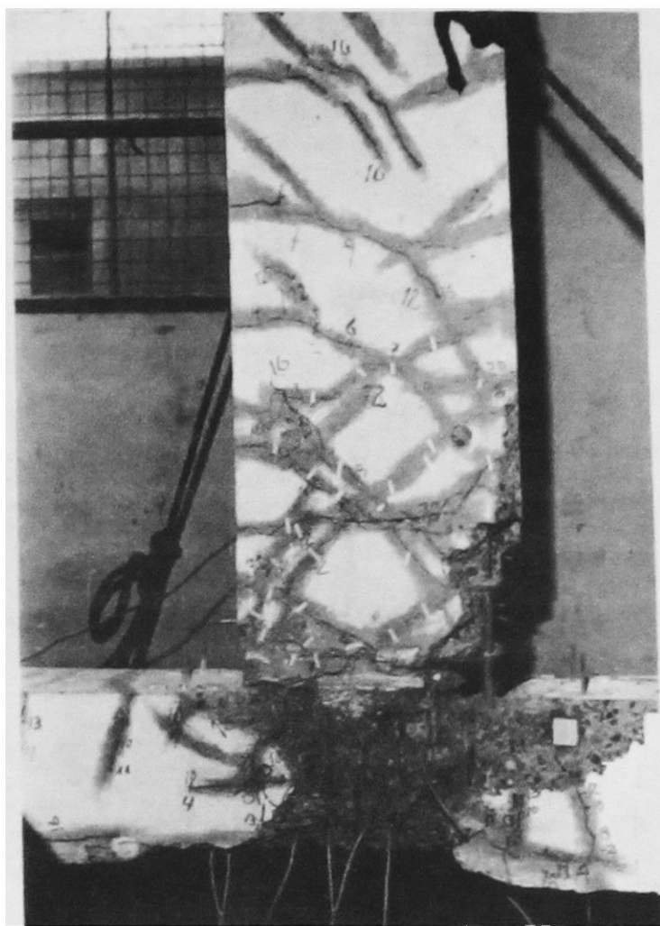
Fig. 11. Estado de la probeta 3 después de la rotura. Se muestra durante el proceso de reparación.
